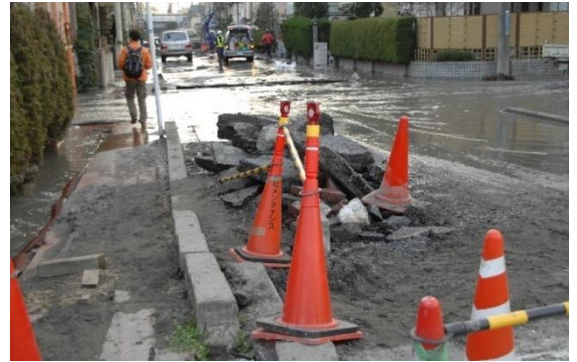
市内の液状化の様子（道路）
